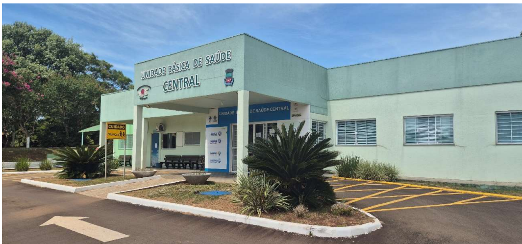
Fotos 1 e 2: Fachada Principal. Retirar letreiro e placas para corrigir fissuras e fazer a pintura.
