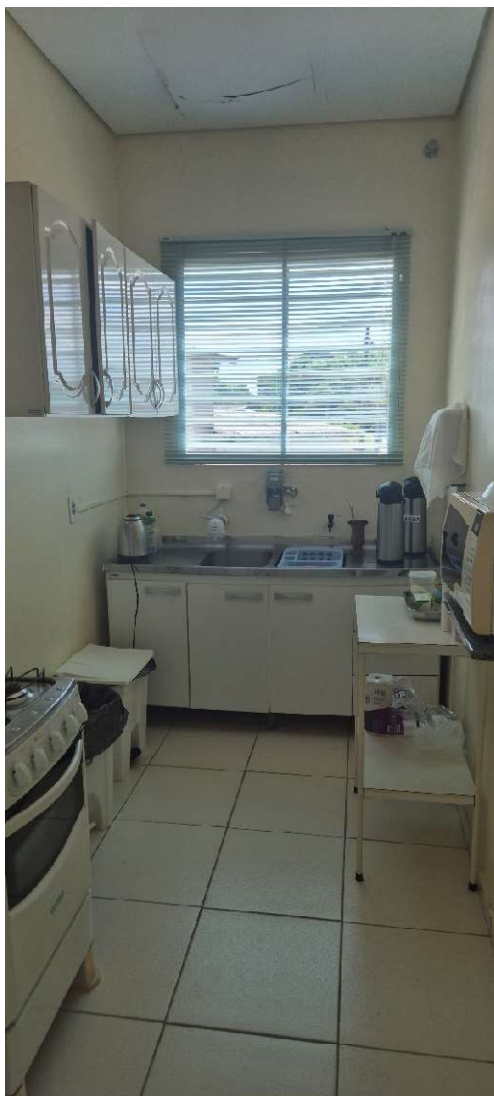
Fotos 6 e 7 Substituir as placas de gesso danificadas, passar massa corrida e pintar.
