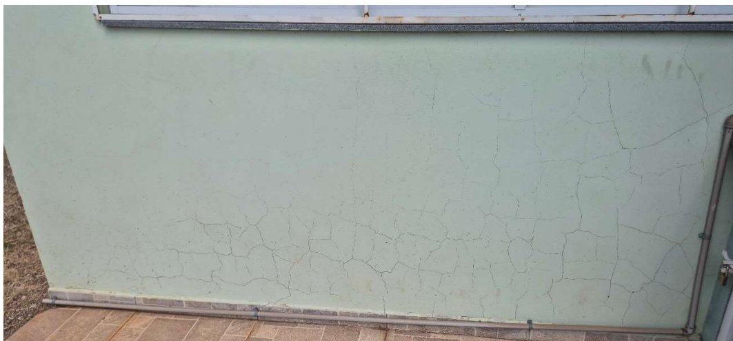
Foto 6 : Vista externa, corrigir fissuras.
