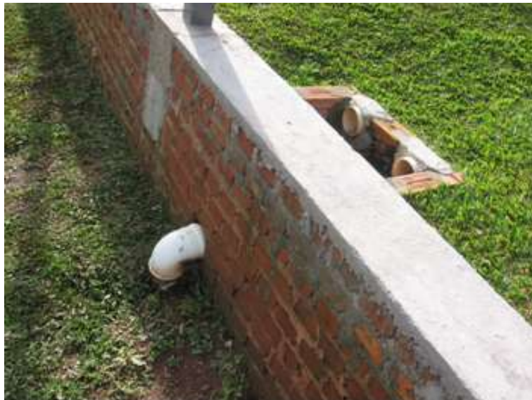
Figura 49 - Lançamento de esgoto diretamente em solo
