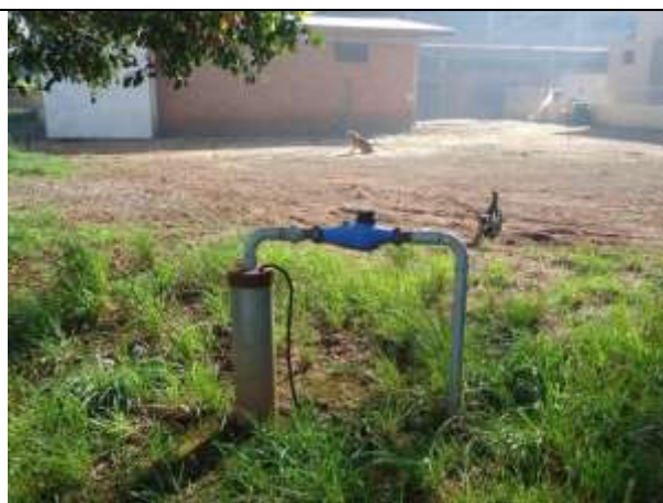
Figura 32 - Poço localizado na comunidade de São José do Centro 1
